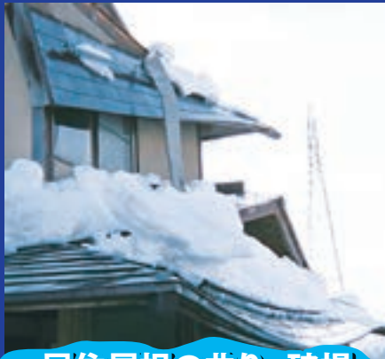
居住屋根の曲り・破損
