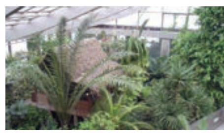
▲高温水を送るための配管 ▲板橋区立 熱帯環境植物館
