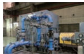
◀蒸気タービン式発電機
