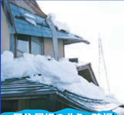
居住屋根の曲り・破損
