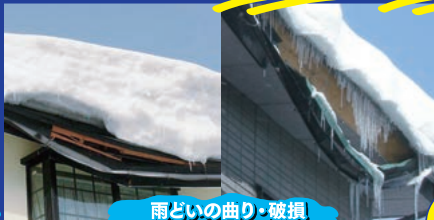
居住屋根の曲り・破損
